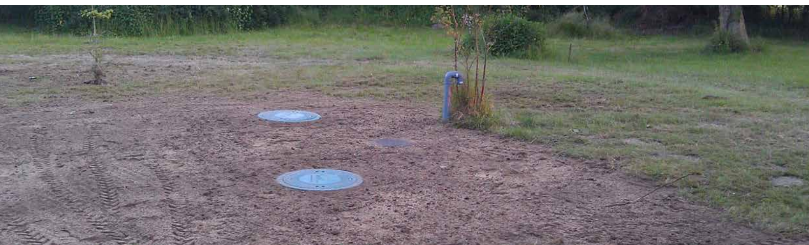
Færdigetableret 15 PE SOP minirenselanlæg til fire husstande.
