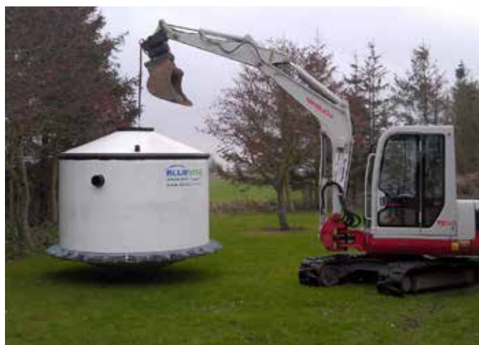
Plastbeholder i samme design som betonmodellen; Her ses et 10 PE anlæg.
